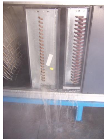
Photographie de la batterie chaude « fuyarde » du bâtiment UO2
