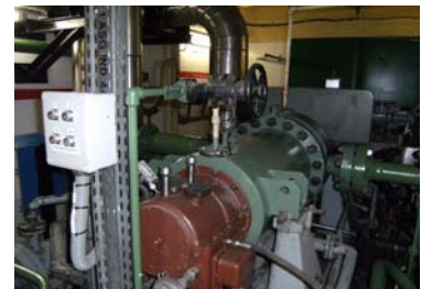
Photo : pompe ASG
